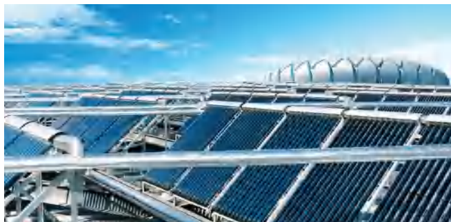
力诺瑞特承建的济南奥体中心大型热水工程
