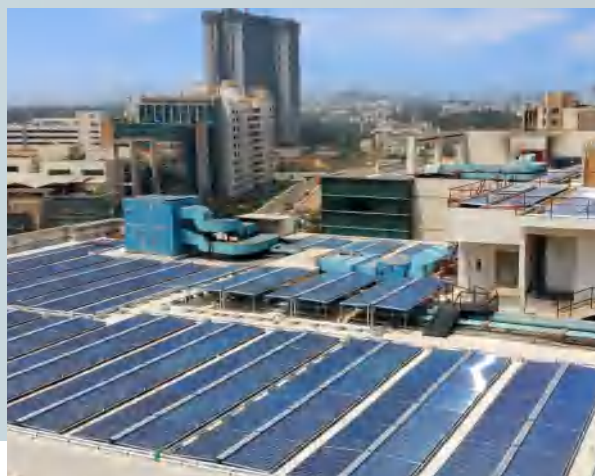
力诺瑞特承建的印度IBM工业园区太阳能中温制冷工程
