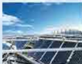
力诺瑞特济南奥体中心太阳能热水项目
